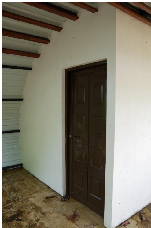
Daños materiales por intento robo
