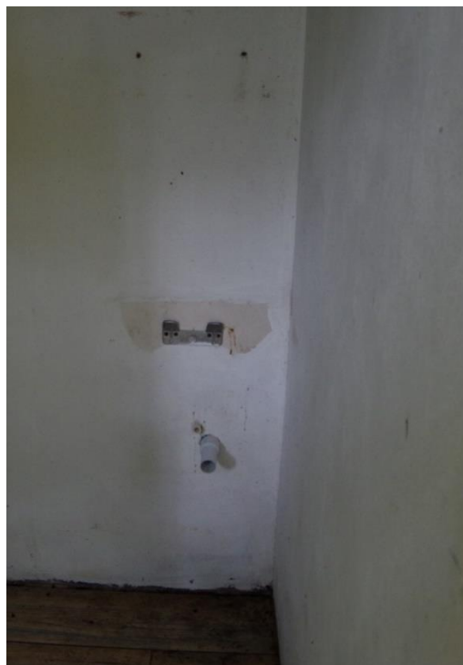
Robo de Lavatorio y otros
