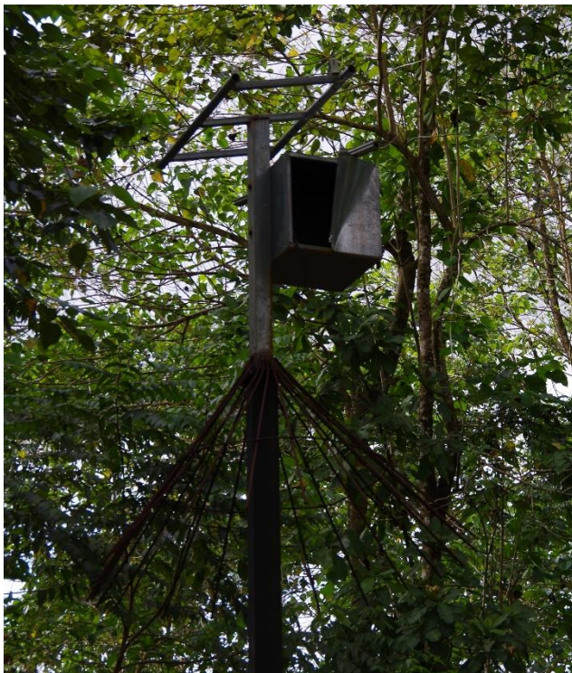
Restos de la instalación del panel solar
