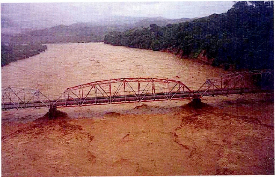
Fig.7. Vista del río Terraba durante el Huracán César. Julio de 1996
